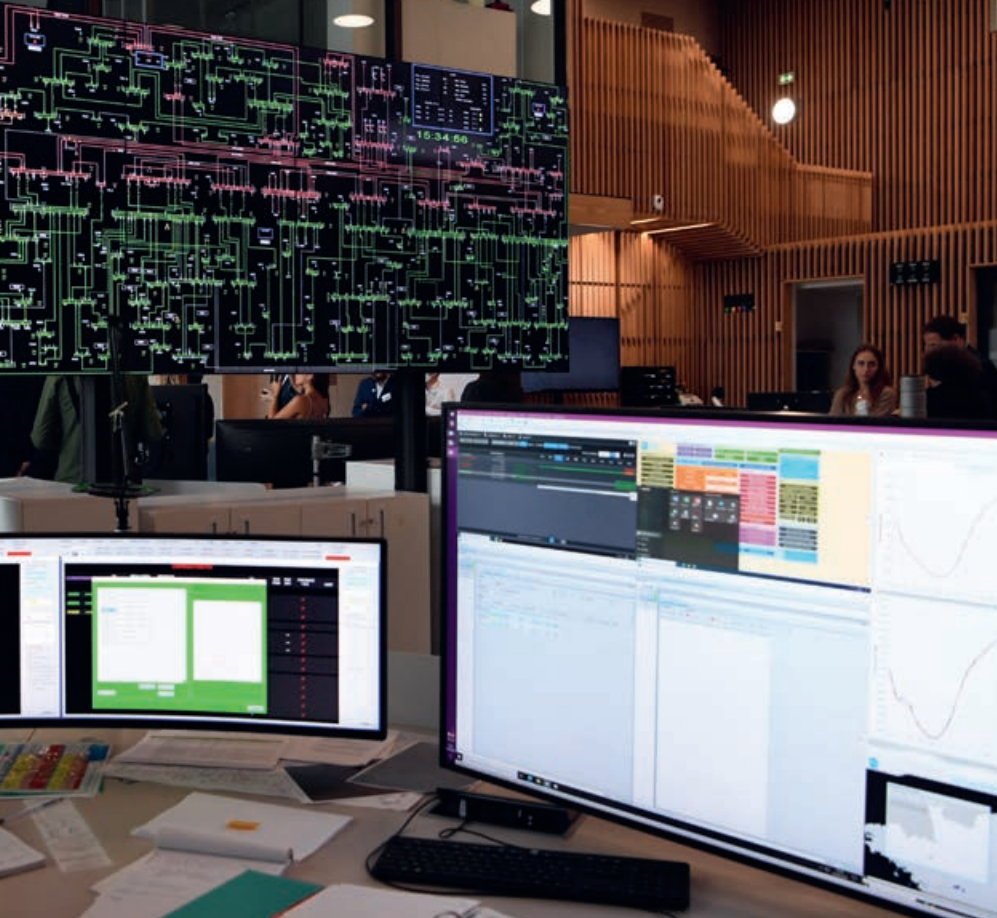
► Salle de contrôle du réseau électrique RTE, à Montigny-le-Bretonneux, en 2022.
